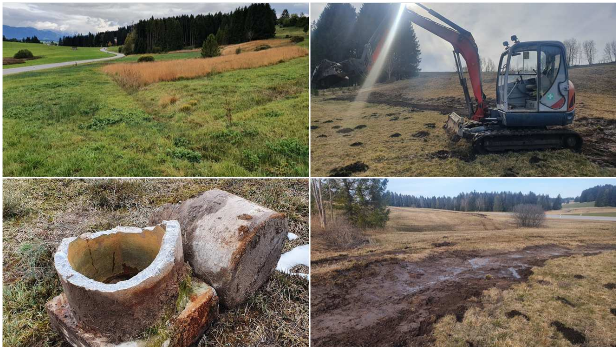
Abb. 45: Bilder des ÖK-Steingaden: Im Bild oben links sind die offenen Gräben noch erkennbar. Die Bilder rechts oben und unten zeigen die Verfüllung der Gräben. Unten links: Die rückgebaute Quellfassung (Fotos Haupt/ Bannaski).
