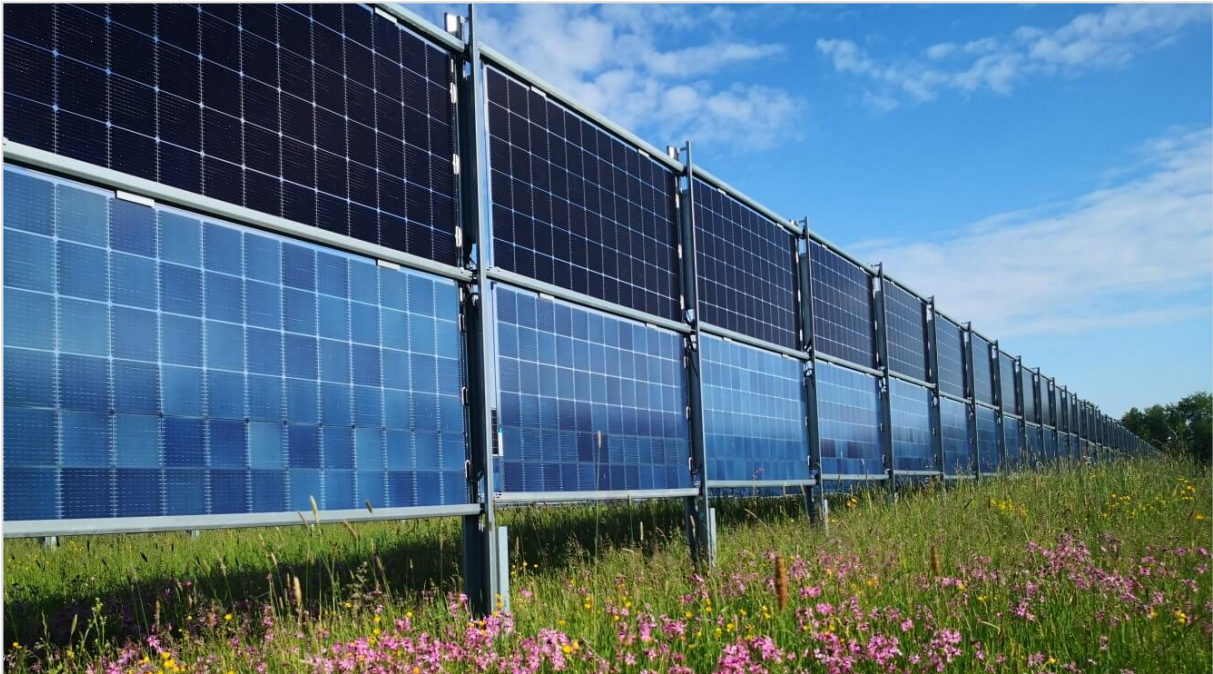
Abbildung 31: Wechselseitige Anordnung bei bifazialen Modulen in vertikaler Ausrichtung (Next2Sun GmbH, 2021).
